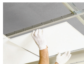
Les panneaux sont démontables individuellement
