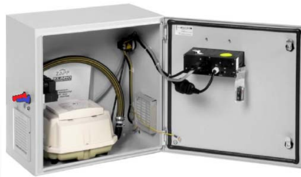
Armoire interne métallique
