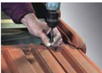
Fixation des tuiles en rives latérales gauche et droite par vis et rondelles d'étanchéité.
